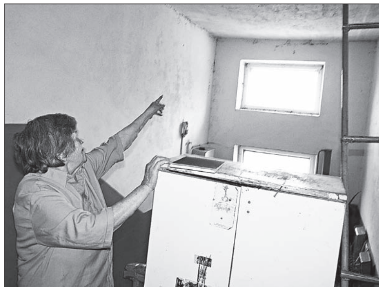
Несмотря на поставленные на чердаке ведра, вода проникает и через потолок общего коридора
