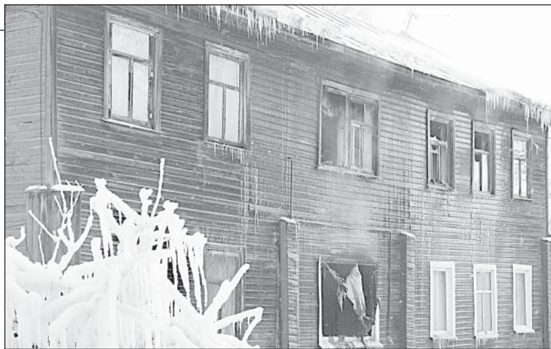
Дом на ул. Свободы в райцентре выгорел изнутри почти полностью
